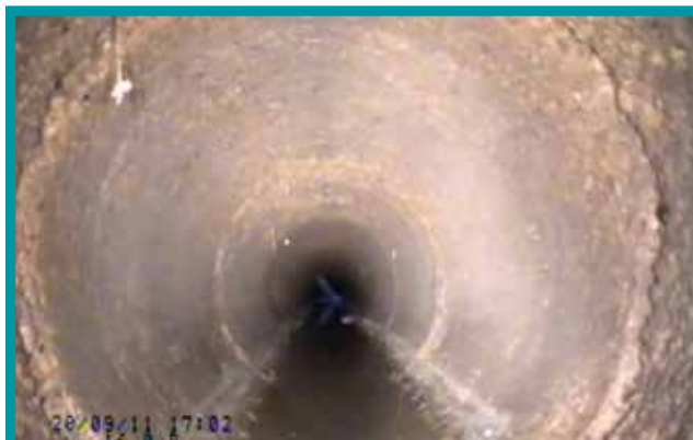
Tubería sin Rehabilitar
