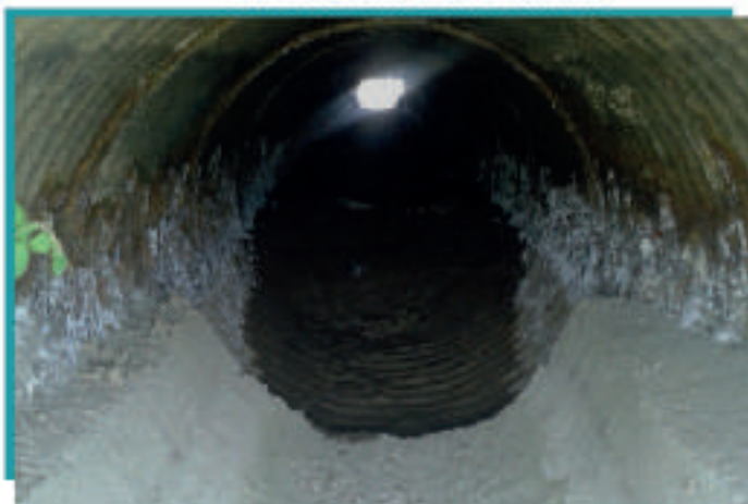
Tubería sin Rehabilitar
